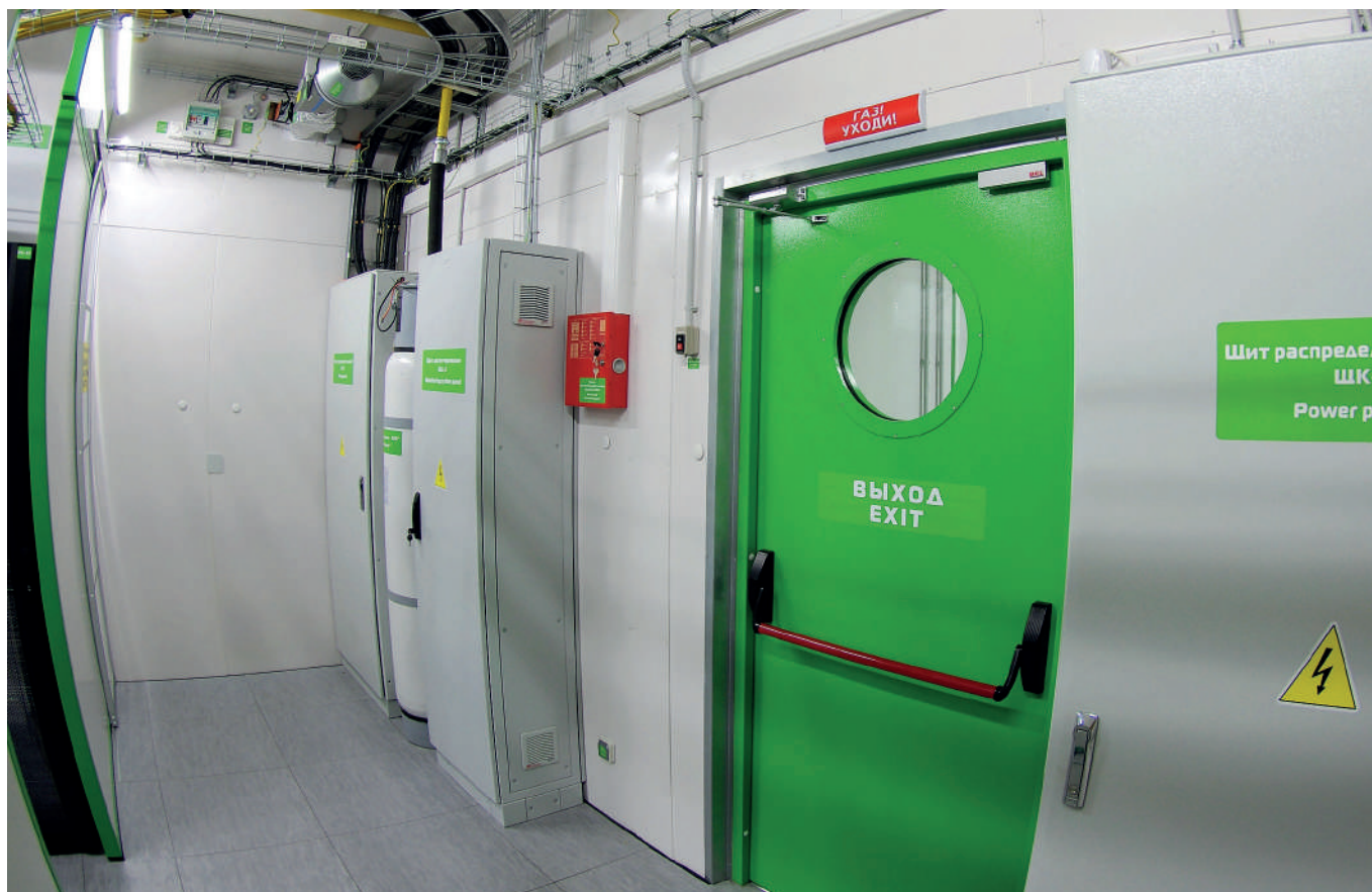
▲ Тамбур серверного блока МЦОД
